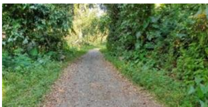
Gambar 10. Gambar Akses Jalan yang Rusak (Dokumentasi Peneliti, 2024)
