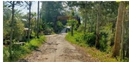
Gambar 11. Gambar Akses Jalan Rusak (Dokumentasi Peneliti, 2024)
